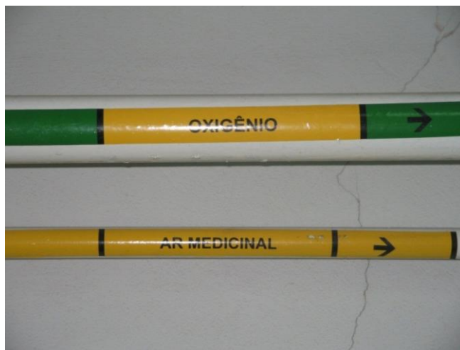
Figura 4 - Tubulação de oxigênio e ar medicinal.
